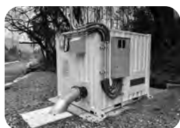
松隈小水力発電所
