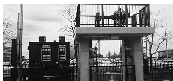
新設された大藤北排水ポンプ
