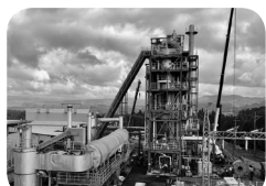
天瀬発電所（木質バイオマス）
