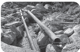
水道管の被災
