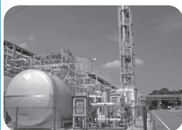
二酸化炭素分離回収設備
