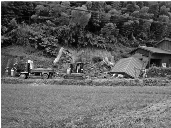
林地崩壊現場（三瀬村中鶴地区）
