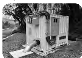
松隈小水力発電所
