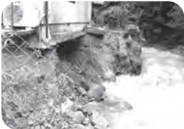
宅地への被害(金立川)
