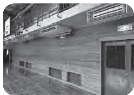
市立体育館(本庄町)に設置予定の空調方式
