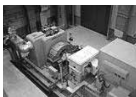
蒸気タービン発電機
