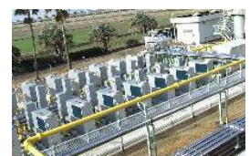
消化ガス発電設備
