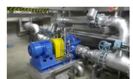
小水力発電設備
