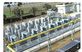
消化ガス発電設備
