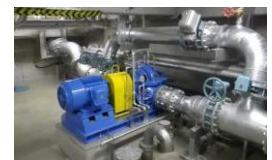
佐賀市清掃工場 小水力発電設備
