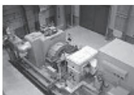
蒸気タービン発電機
