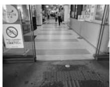
途切れている点字ブロック
