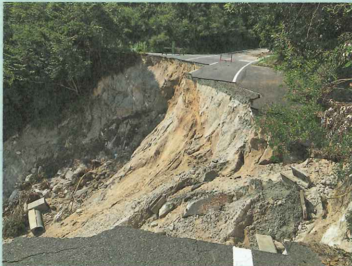
【写真】「西日本豪雨7月6～7日による被害状況」 (富士町大字杉山) ※詳細はP5に掲載
