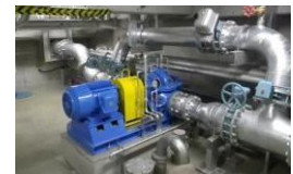
佐賀市清掃工場 小水力発電設備
