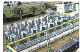
消化ガス発電設備
