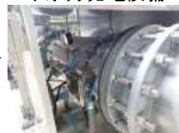
洞鳴の滝ふれあい館 小水力発電設備
