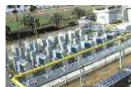
消化ガス発電設備
