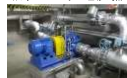
佐賀市清掃工場 小水力発電設備
