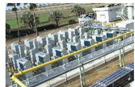
消化ガス発電設備
