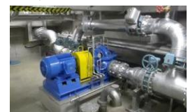
佐賀市清掃工場 小水力発電設備
