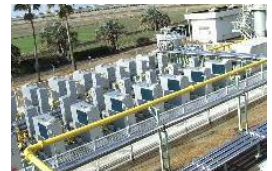
消化ガス発電設備
