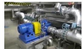
佐賀市清掃工場 小水力発電設備
