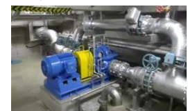
佐賀市清掃工場 小水力発電設備
