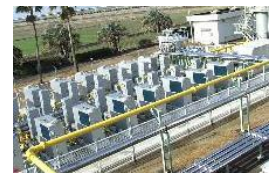
消化ガス発電設備
